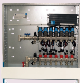
Heizkreisverteiler, Kaltwasserzähler & EGO-Regelantrieb für Fußbodenheizung
